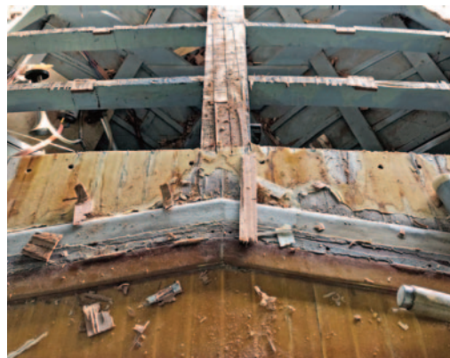
In der Werft des Holzspezialisten Armin Hellwig in Altenholz bei Kiel wurden Teile des Decks wegen deutlicher Wasserschäden erneuert.
